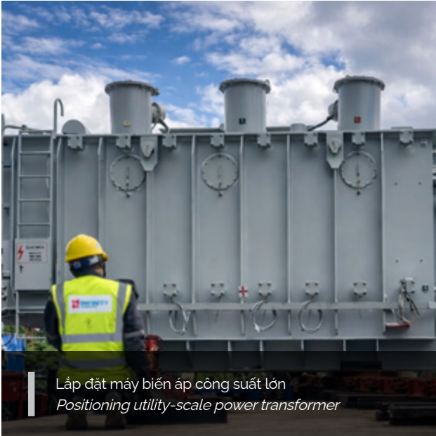
Sân trạm biến áp nâng áp ngoài trời và hệ thống cột xà. Outdoor substation switch yard and gantry structures.
