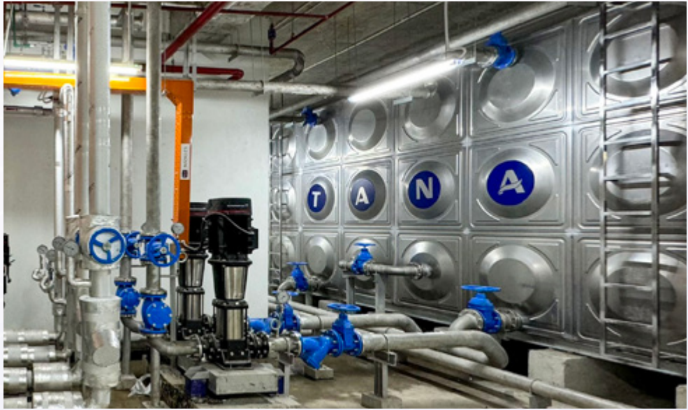
Hệ thống bể nước lắp ghép bằng thép không gỉ và cụm bơm tăng áp biến tần. Sectional stainless steel water tank and inverter booster pump system.
