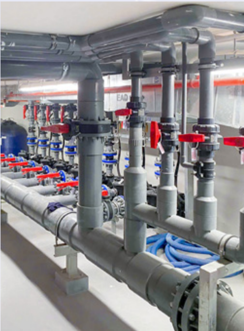
Hệ thống trục đường ống cấp nước và van chặn trung tâm. Central water supply pipeline and isolation valve assembly.
