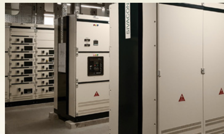
Hệ thống tủ điện phân phối tổng Main Switch Board (MSB) system
