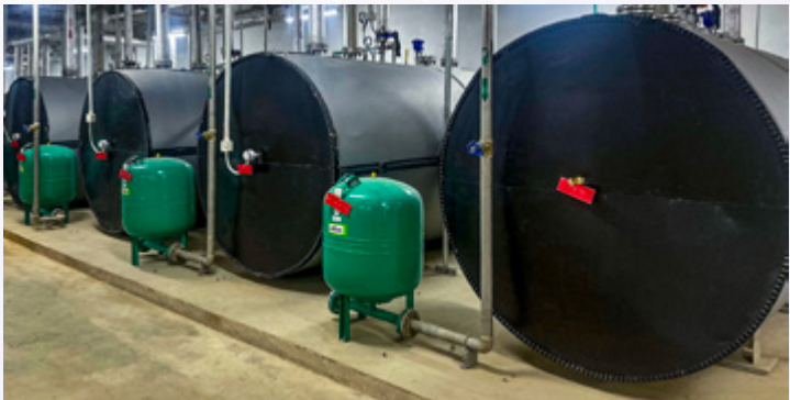
Hệ thống bồn chứa nước sinh hoạt trung tâm và bình tích áp. Central domestic water storage tanks and pressure vessels.
