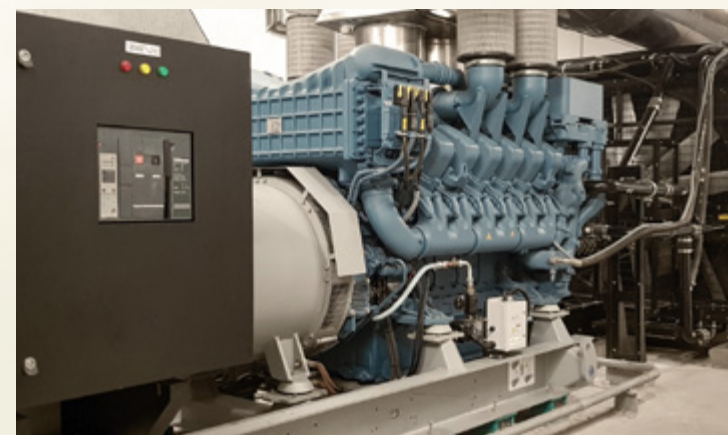
Máy phát điện dự phòng Backup power generator
